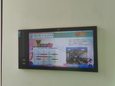
图 12 每个教室外安装了智慧班牌
